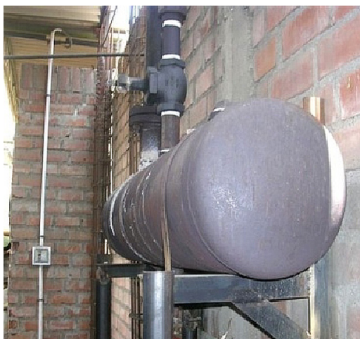
Figura 30. Antes de la implementación: Manifold y redes de distribución sin aislamiento térmico
