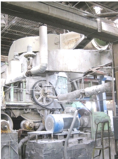
Figura 36. Equipos de tecnología obsoleta
