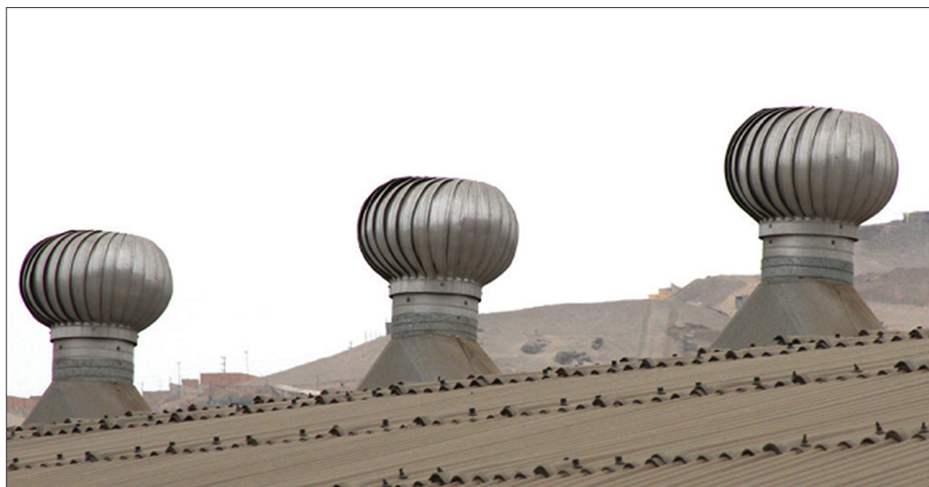
Figura 28. Extractores eólicos instalados en la planta
