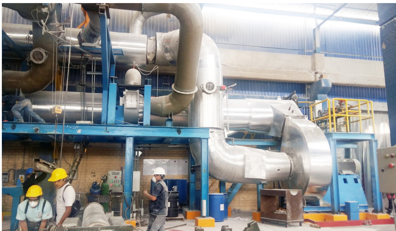
Figura 38. Instalación de quemador de alta eficiencia en el Yankee de la máquina papelera 3
