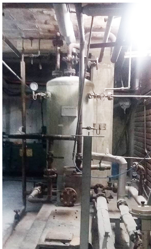
Figura 40. Tanque Flash en mejores condiciones de operación
