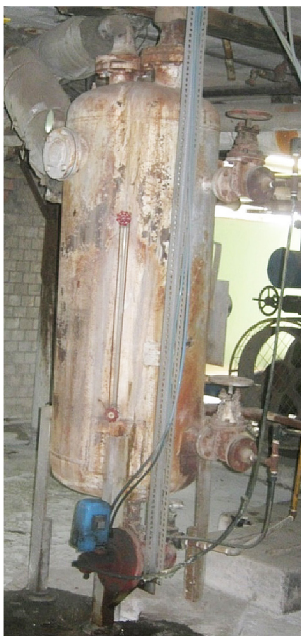
Figura 39. Tanque Flash en condiciones ineficientes
