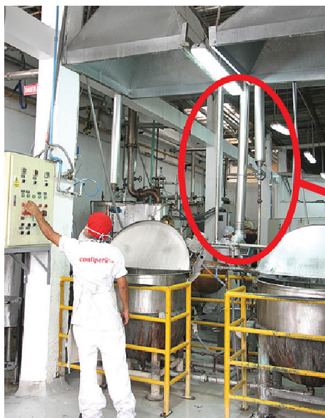
Figura 26. Las tuberías de distribución de vapor
