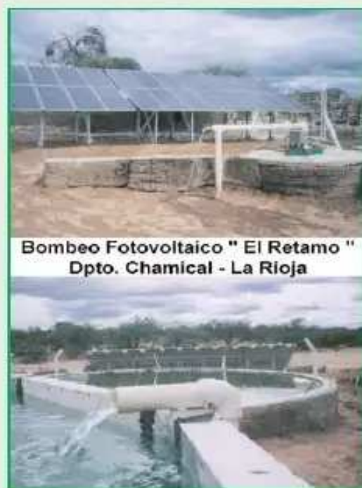
Fig. 3. Sistema de bombeo Fotovoltaico
