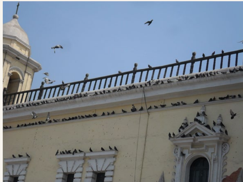
Palomas en paredes de estructuras aledañas a la Iglesia de San Francisco.
