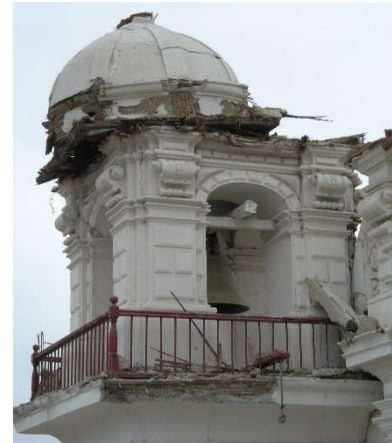
Estado del cupulín de la torre de la Capilla luego del terremoto. Imagen: More y Navarro-Grau, 2009.
