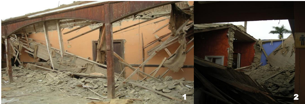
1 y 2. Estado de la Casa Hacienda San José luego del terremoto, techo y muros colapsados. Imágenes: More y Navarro-Grau, 2009.
